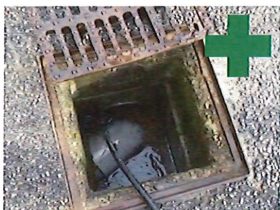
Avaloir d'eau pluviale avec bac de décantation
