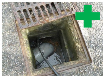
Avaloir d'eau pluviale avec bac de décantation
